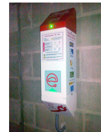
Punto recarga eléctrico
